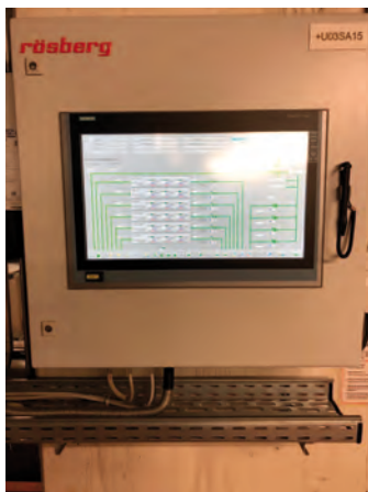
Bild 2: Bedien- und Beobachtungsmöglichkeit des Untergeschosses via Touch Panel
