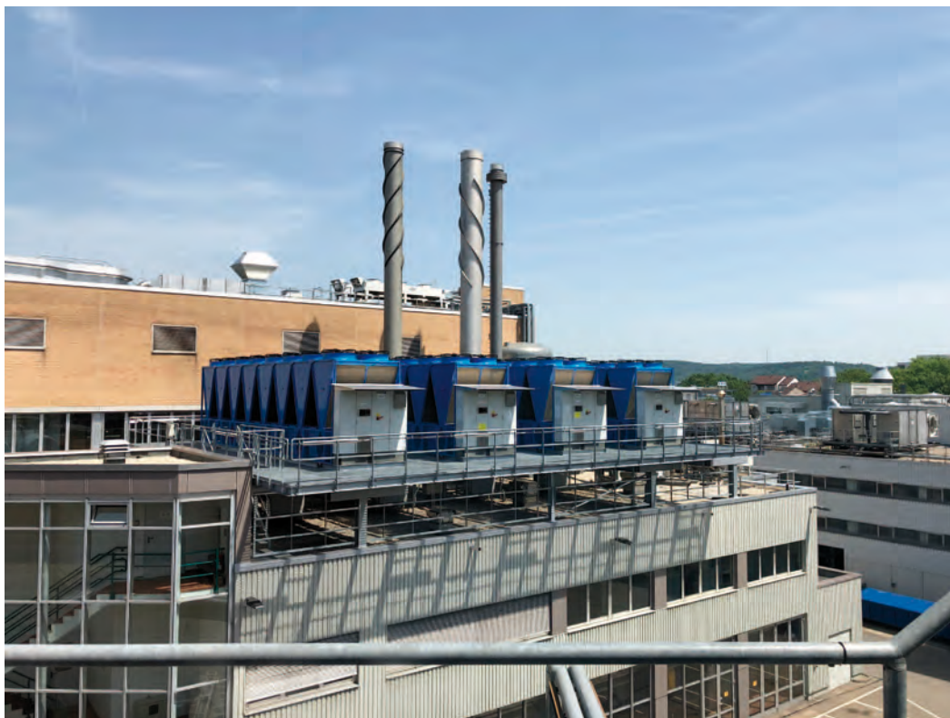
Bild 3: Vier neue Kompressor-Kältemaschinen auf dem Dach der Energiezentrale Alle Bilder: Rösberg
