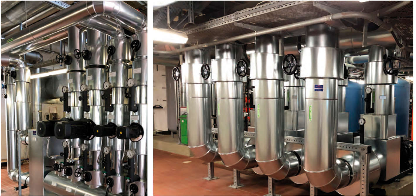
Bild 4: Links im Bild der Verteiler für Kaltwasser, rechts der Kaltwasservorlauf
